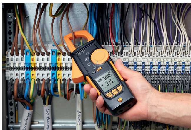
Misura della corrente in un quadro elettrico.
